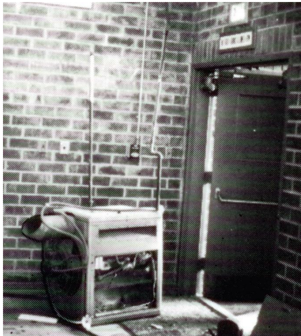
איור 1-6.4.1.6 – מערכת לחימום בגז שנפלה מהתקרה עקב רעידת אדמה.
