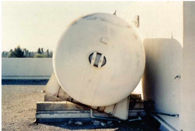
איור 6.4.2.1-1 – מיכל על אוכף שהחליק.
