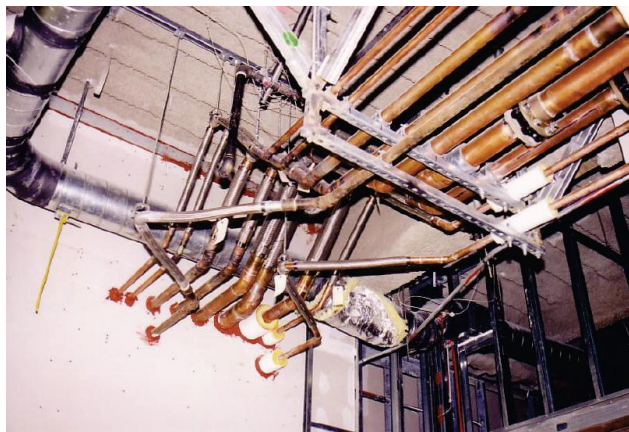
איור 6.4.3.8-4 – צנרת חודרת קיר בחזית עם עיגון צידי, מהדקים גמישים עם תמיכות אנכיות עצמאיות ואיטום החדירה בקיר.
