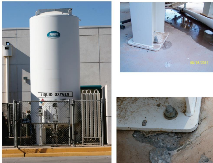
איור 5-6.4.2.1-5 – נזק במיכל בבית חולים.
