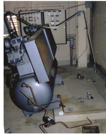
איור 1-6.4.1.3-1 – כשל בעיגון מדחס היושב על מבודדי ויברציה מסוג קפיצים.
