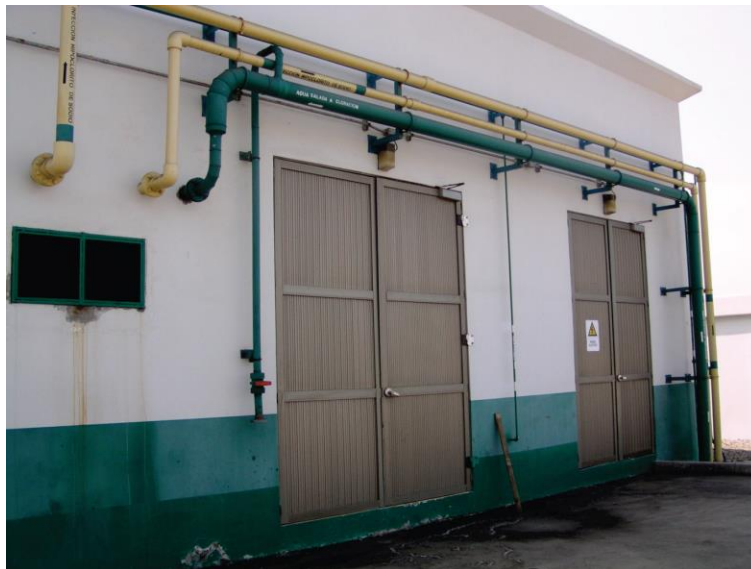
איור 6.4.3.7-1 – עיגון צנרת אופקית ואנכית לקיר חיצוני. ניתן לראות כי נוצר נזק קל לצנרת הירוקה החודרת לקיר וכי המחברים הוסטו קלות, אך העיגון תפקד טוב באופן כללי.
