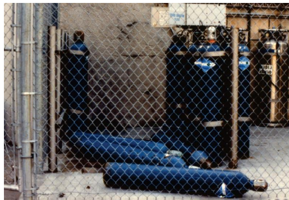
איור 6.4.2.3-1 – בלוני גז שאינם מעוגנים ונפלו עקב רעידת אדמה.
