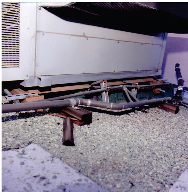
איור 6.4.3.6-1 – נזק לצנרת ומערכת מיזוג על גג, כשל התרחש בפלטת העץ ופרופילי הפלדה.
