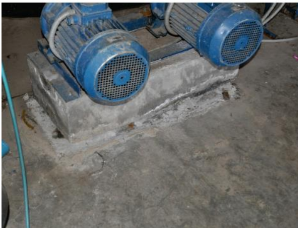
איור 6.4.1.1-2 - כשל בבסיס אליו עוגנו המשאבות.
