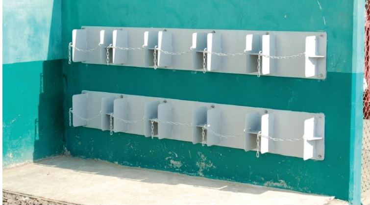
איור 6.4.2.3-4 – עמדות עגינה המיועדות לבלוני גז מחוברות לקיר.
