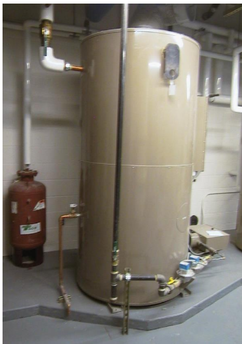
איור 6.4.2.4-5 – דוד מים בבית ספר מעוגן בבסיסו.
